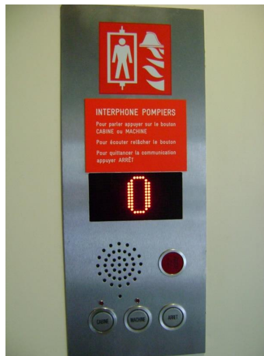
Signalisation de l'interphone au niveau du point d'intervention des pompiers dans le bâtiment
