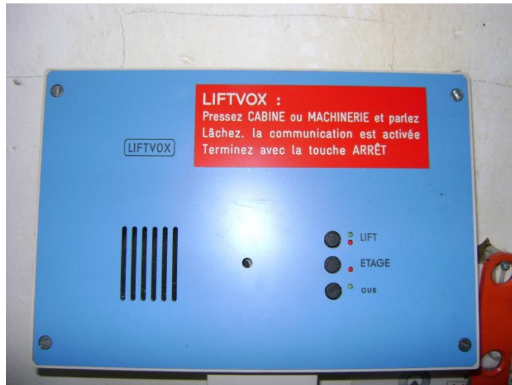
Signalisation sur l'interphone du local des machines
