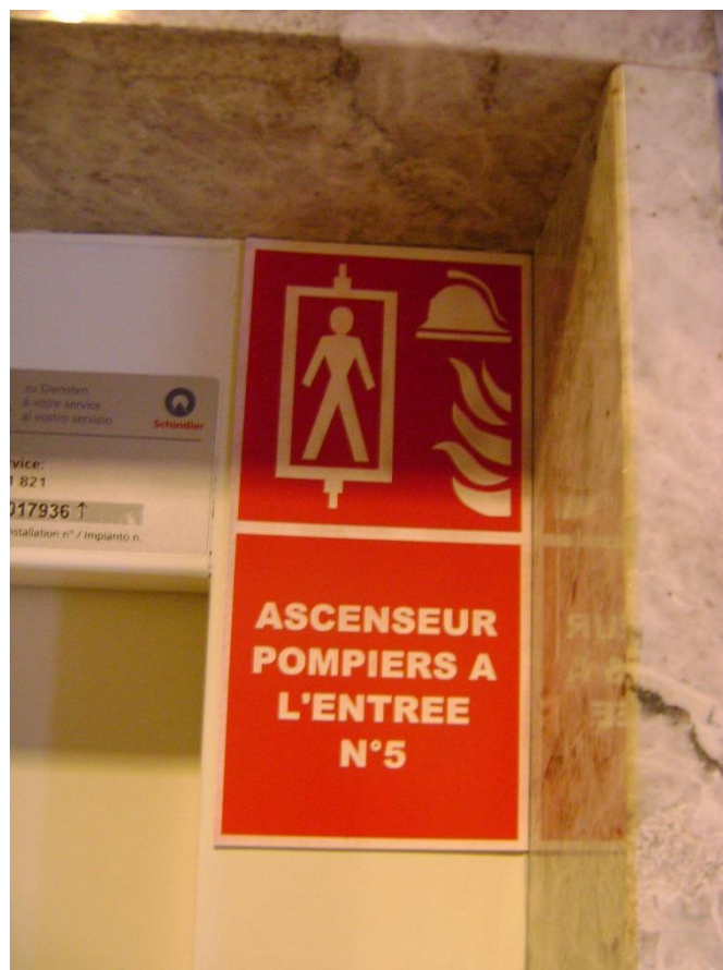
Signalisation sur les autres ascenseurs et monte-charge de l'immeuble.
